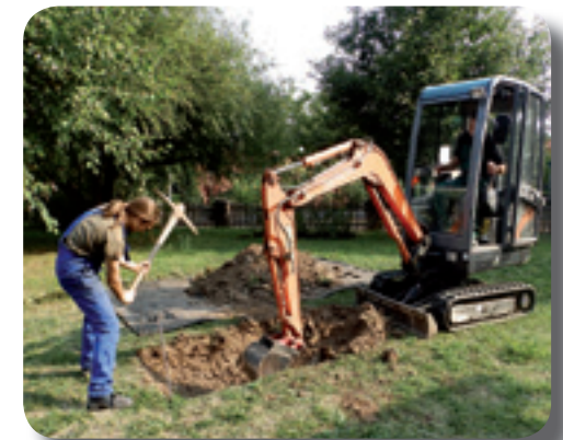
Das Ausheben der Glockengrube durch Mitarbeiter des Kolpingwerkes, in der später die beiden Glockenformen vergraben werden.
